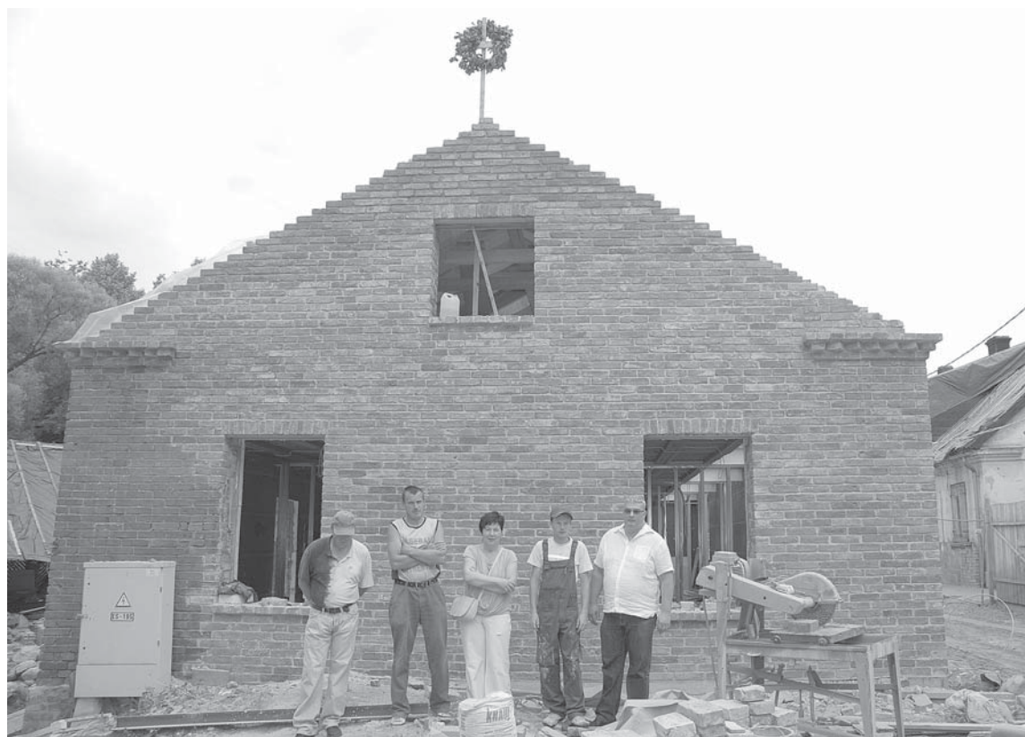
Kuldīgas novada pašvaldības projektu vadītāja Iveta Heidena (centrā) un SIA „Kurzemes līgzda” valdes priekšsēdētājs Ģirts Egle (no labās) kopā ar celtniekiem pie jaunās administrācijas ēkas.
